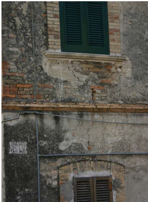
Figura 2: lesioni per rottura da taglio verticale agli appoggi degli architravi ad arco.
