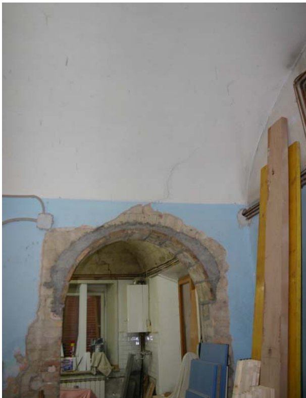
Figura 4: lesioni per insufficiente resistenza del nuovo arco.
