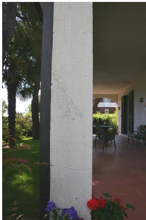
Figura 3. Lesioni reticolari su alcuni pilastri del portico, dovute allo sviluppo di reazioni alcali-aggregati per interazione tra il cls e l'ambiente.
