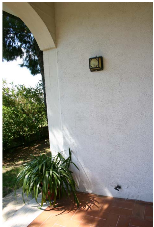
Figura 5. Lesioni sui muri perimetrali portanti convergenti verso lo spigolo di sud-est e legate ad un tipico cedimento fondale d'angolata.
