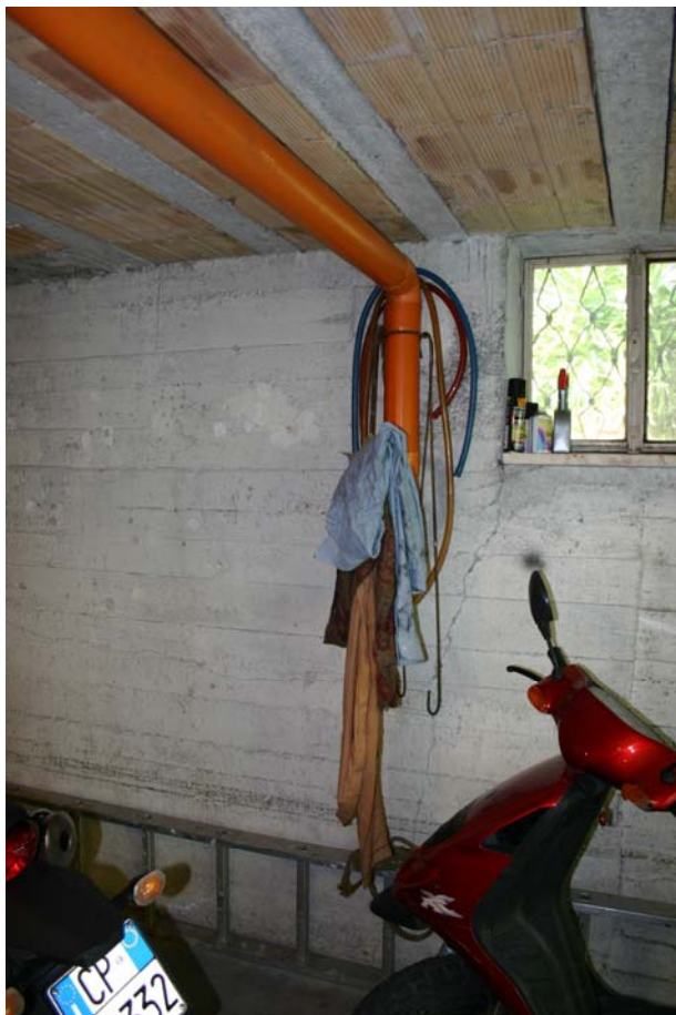
Figura 2. Lesioni sul muro in cemento del piano interrato, riconducibile principalmente a mancanza dell'armatura, a riprese di getto mal eseguite ed infine al cedimento fondale del settore a dx della foto.
