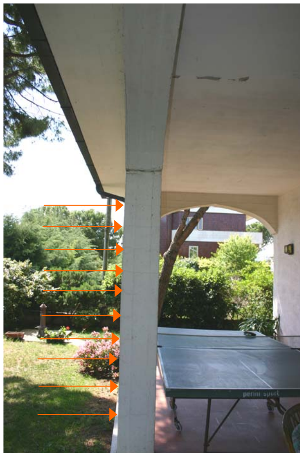
Figura 1. Ossidazione delle staffe di armatura (indicate dalle frecce rosse) su pilastro interno del portico, per insufficienza del copriferro.
