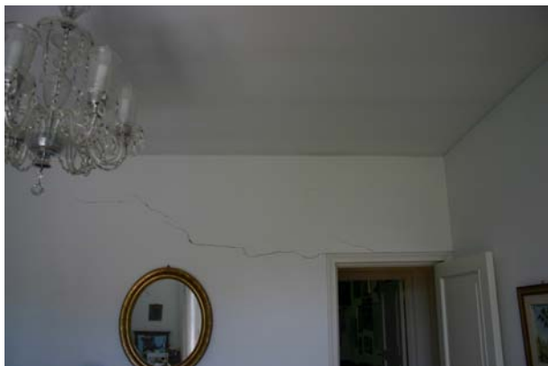
Figura 4. Lesioni per azione combinata di flessione+taglio, interessanti la tramezzatura del piano terra e dovuta a insufficienze strutturali.
